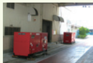
甲府工場に導入された発電機
