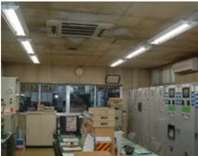
三重工場 照明設備をインバータ付き省エネルギータイプに切り替え
