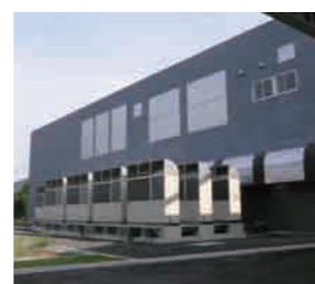
LNG使用のGHP設備 (中部商品センター)
