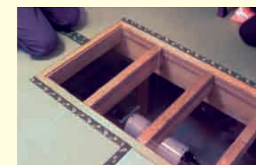
自宅にも免震装置を設置。お客様にご覧いただけるよう、畳の一部をガラス張りに。
