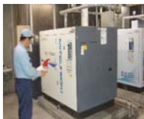
▲水潤滑方式コンプレッサー（山口工場）
