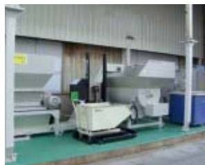
▲固形化処理装置（甲府工場）
