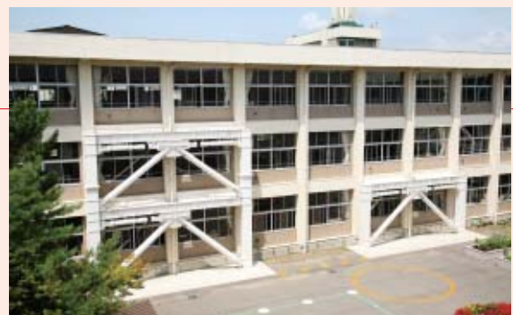
▲減衰こまで耐震補強した秋田市の築山小学校校舎外観
