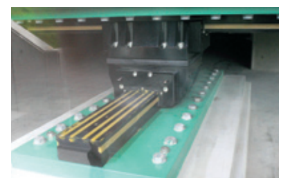
関ヶ原町役場の基礎に設置されている免震設備(岐阜県)
