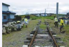
津波被害を受けた線路
