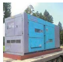
設置した発電機
