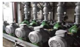
クーラント供給ポンプモーター
