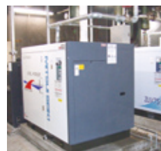
山口工場エアーコンプレッサー
