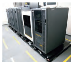
サーバーと免震装置
