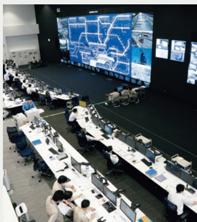
床免震が施された管制官室
