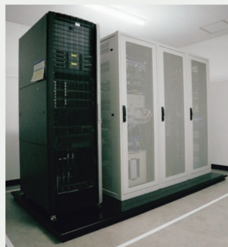
新防災棟に設置した免震を施したサーバー
