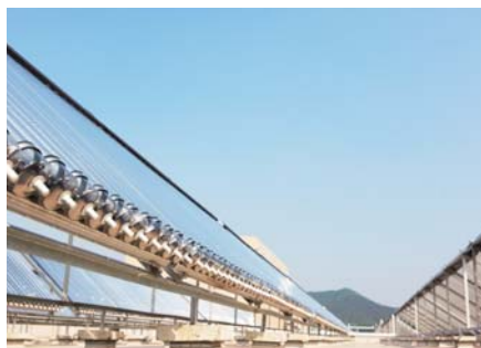
太陽熱温水器 (温水はシャワーや手洗いのほか暖房用にも使用)
