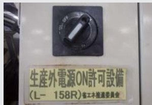
電源を切らなくて良いものを表示札で明確化
